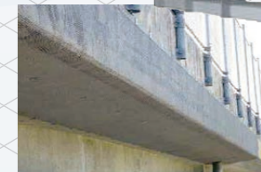
剥落防止ネット
