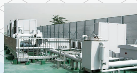
室外機騒音対策
