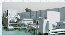
室外機騒音対策
