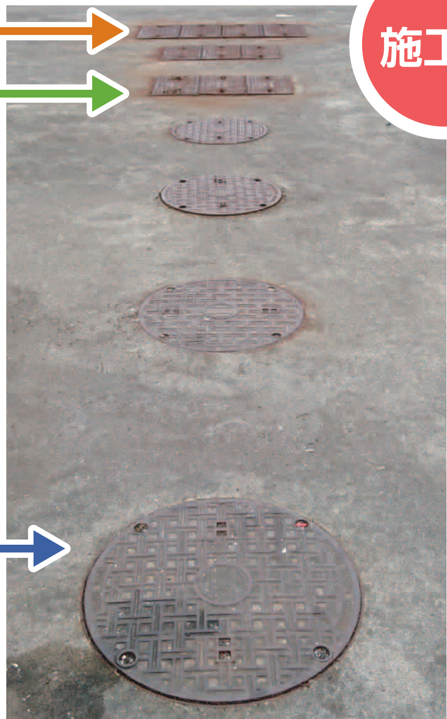
鉄製蓋全体に錆が出ています。
